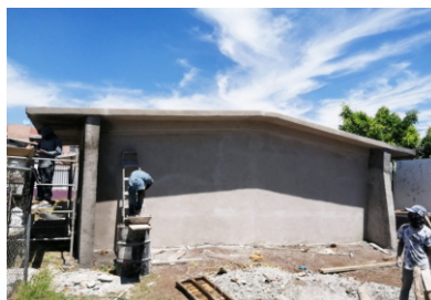
Construcción de Comedor Escolar, Jardín de Niños José Francisco Trinidad Salgado, Col. La Paz
